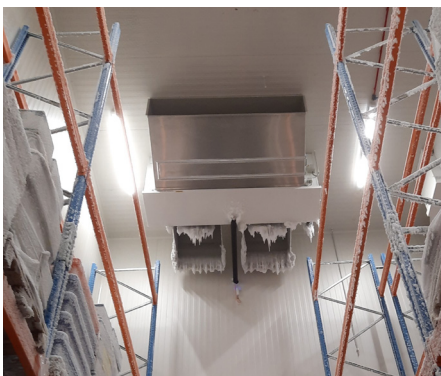
L'umidità e il ghiaccio minacciano l'ambiente di lavoro nella cella di congelamento.
