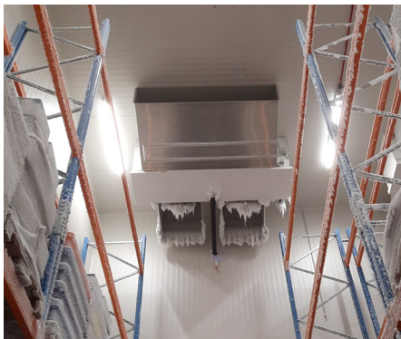
Fugt og is truer arbejdsmiljøet i fryserum.
