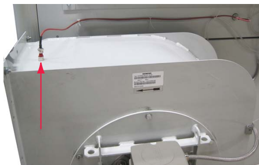
Рисунок 3.21 Подключение датчика РТ1000 на вентиляторе воздуха реактивации
