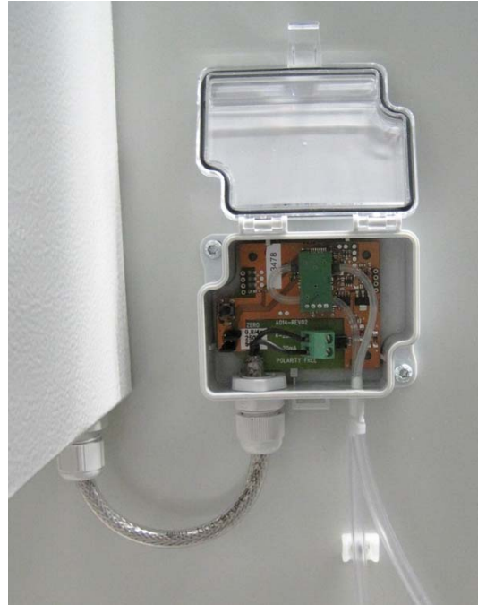
Kuva 3.23 DPT:n liitäntä (kuivattavan ilman puhallin)
