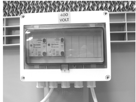
Fig10 Cuadro eléctrico de distribución
