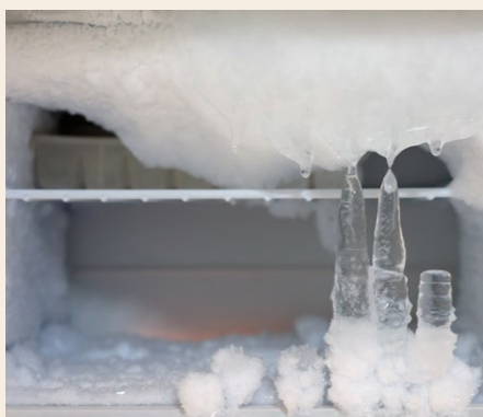
Oblodzenie osprzętu i urządzeń.
