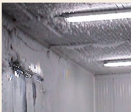
Ekstremalne oblodzenie sufitu.
