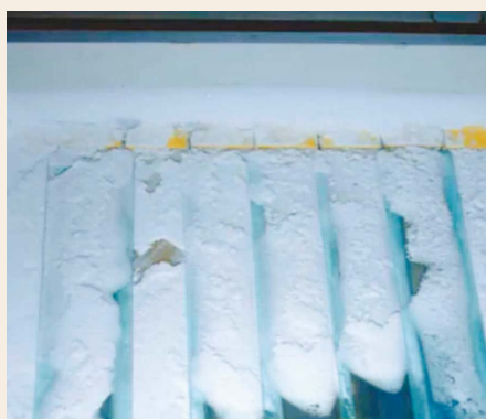
Ijsafzetting in het laadperron.
