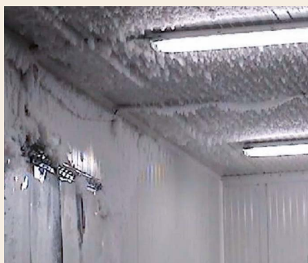
Extreme ijsvorming op het plafond.
