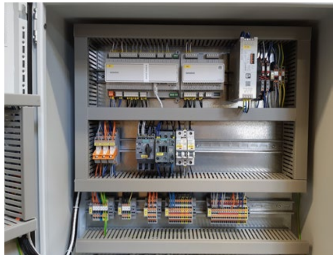
Schaltschrank – Außen- und Innenansicht
