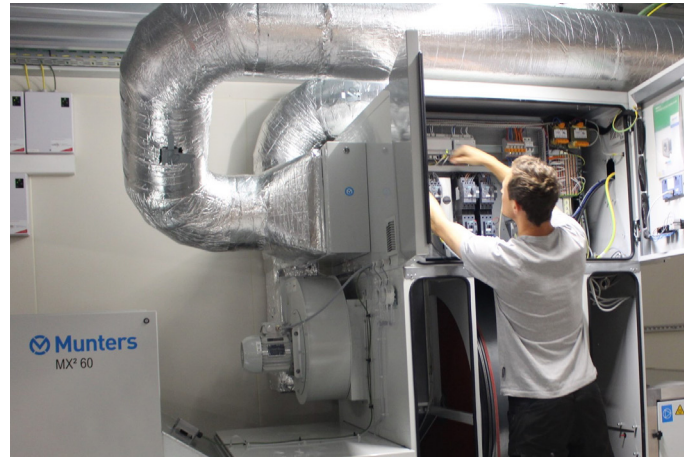
Ein Munters Servicetechniker richtet das MX 2 60 Entfeuchtungssystem bei der Bäckerei Kenis ein.
