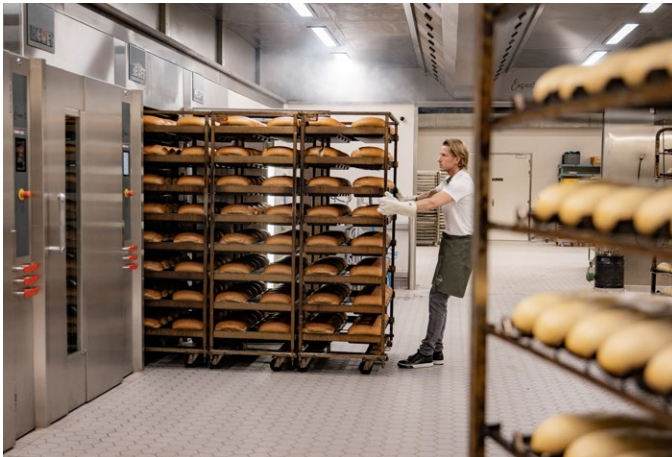
Munters ontvochtiging zorgt voor gelijkmatige afkoeling van broden en pistolets zonder kwaliteitsverlies.
