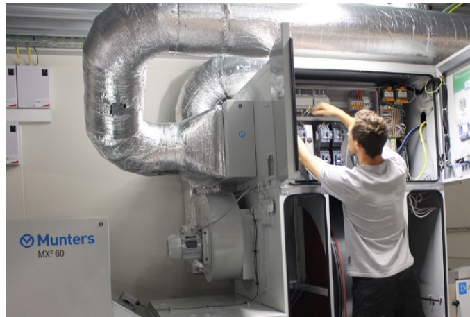
Un technicien Munters configure le MX 2 60 à la boulangerie Kenis.
