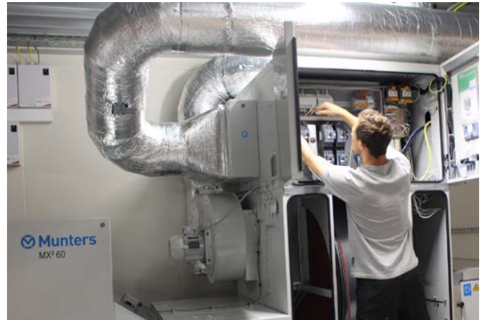
Ein Munters Servicetechniker richtet das MX 2 60 Entfeuchtungssystem bei der Bäckerei Kenis ein.
